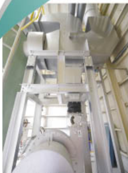
サーモヒーター後方のエアヒーター
