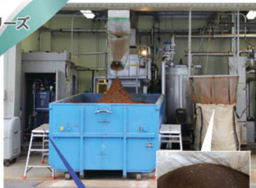
汚泥処理設備
