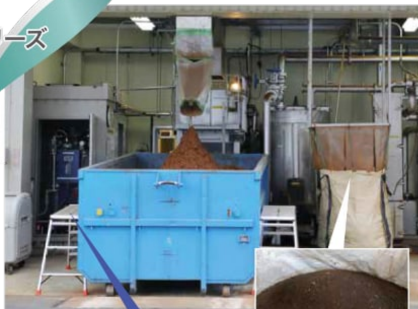
汚泥処理設備
