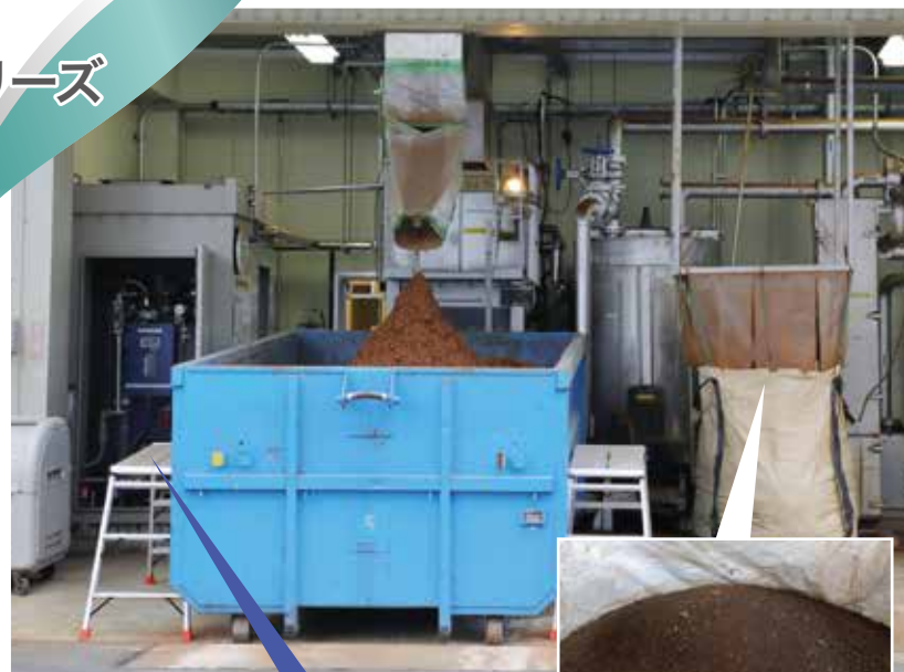
汚泥処理設備
